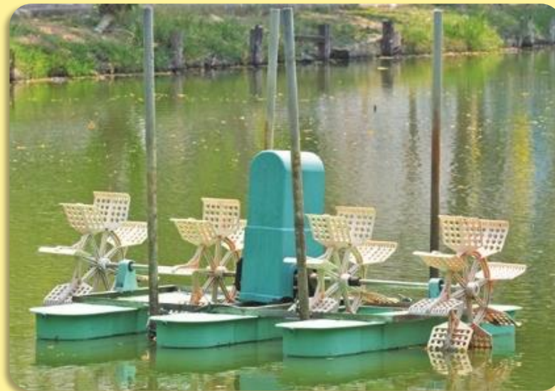
กังหันน้ำบำบัดน้ำเสีย
